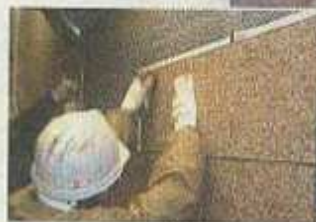
コンクリートなどはく落を防ぐシート状の外装材なども劣化補修に使われています
